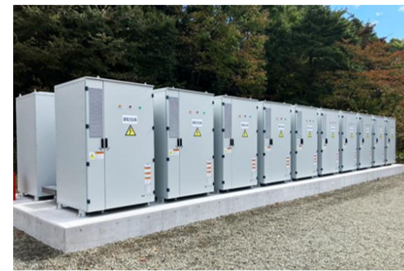
福島二本松蓄電所（福島県）
