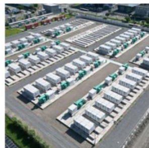
<Recharge Power社 宜蘭特別高圧蓄電所の写真>
