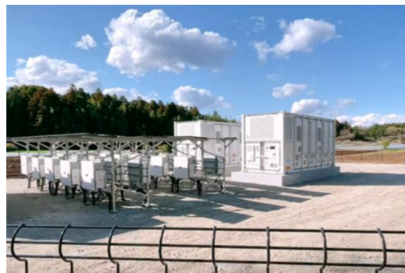
印西蓄電所（千葉県）
