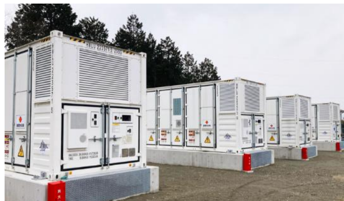
広島三次蓄電所（広島県）
