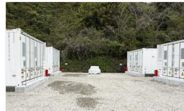
串間蓄電所（宮崎県）
