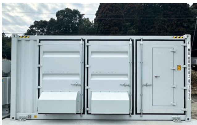
高鍋蓄電所（宮崎県）
