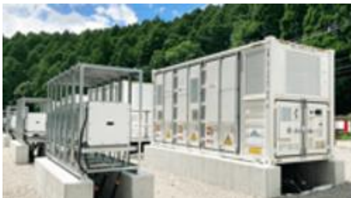
霧島蓄電所（鹿児島県）
