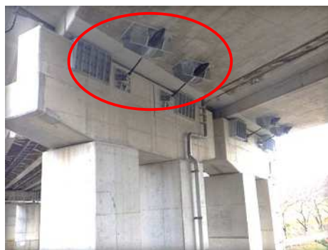
落橋防止システム
