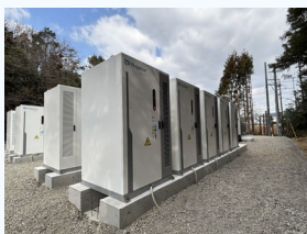
本連系済みの第1 拠点 「ADW三重松阪市蓄電所」
