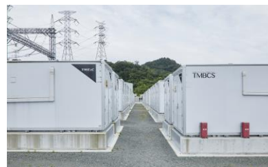
紀の川蓄電所 (2024年運用)
