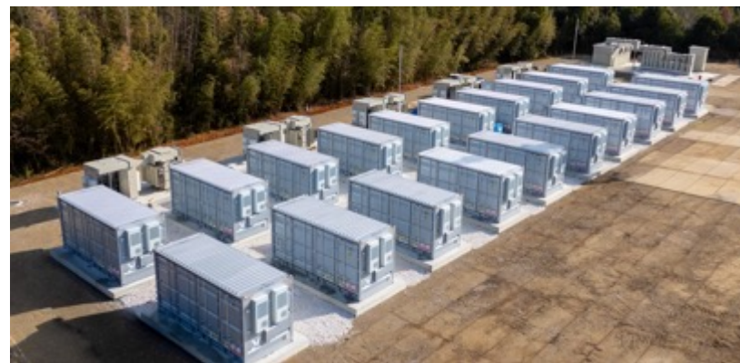
昨年導入した 特高蓄電所の例
