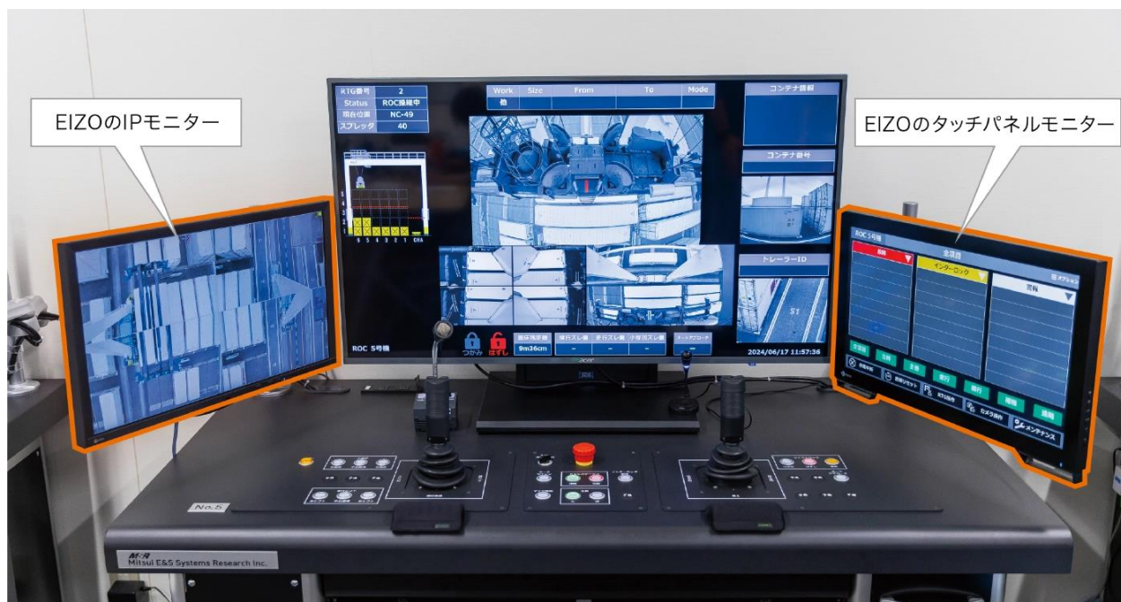
管理棟にある遠隔操作卓
