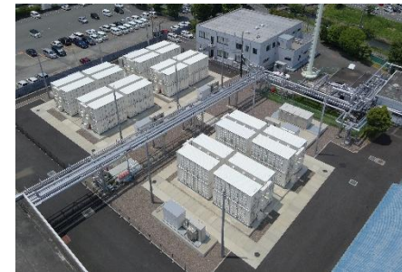
サーラ浜松蓄電所
