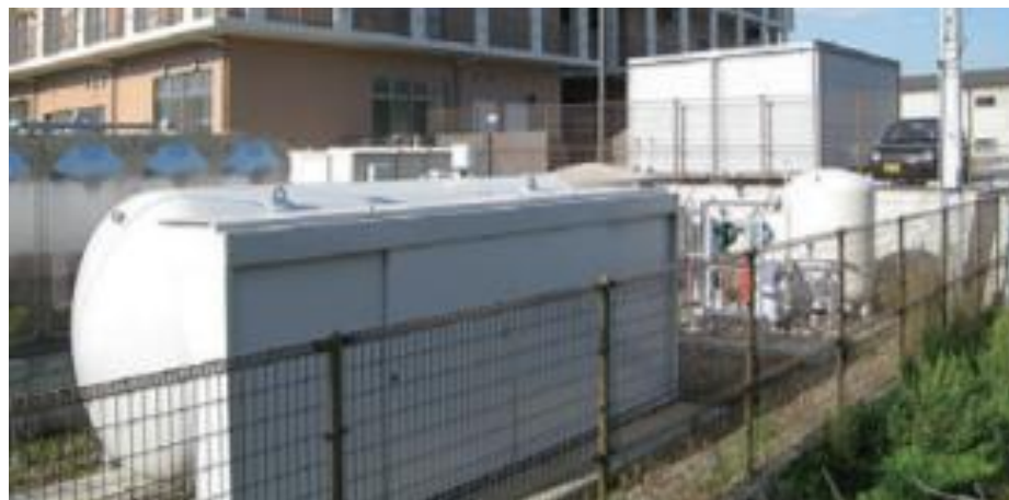
福祉施設（スプリンクラー設備）
