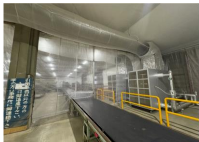
正面左中央:間仕切りシート 正面右奥の機械:エアーハンドリングユニット
