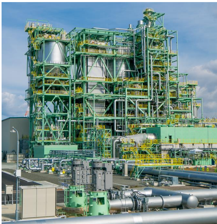
佐賀伊万里バイオマス発電所
