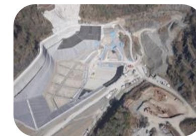
奥山の杜CC（最終処分場）
