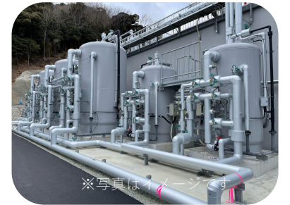
2026年4月以降 稼働予定 新規水処理施設
