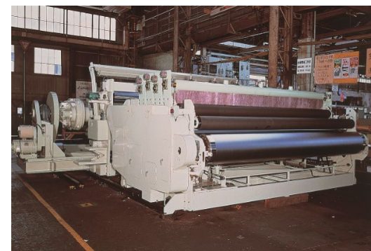
フィルム関連設備
